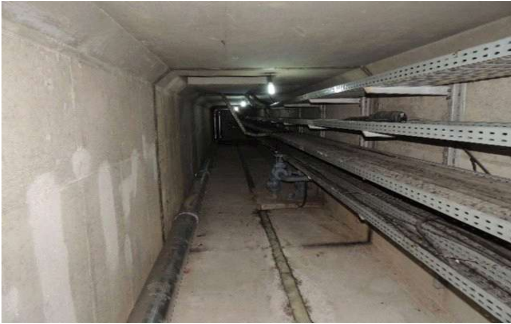
옥외공동구 내부 전경
