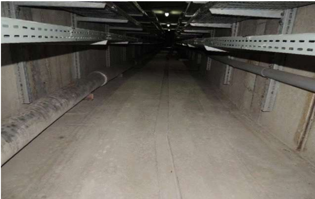
옥외공동구 내부 전경
